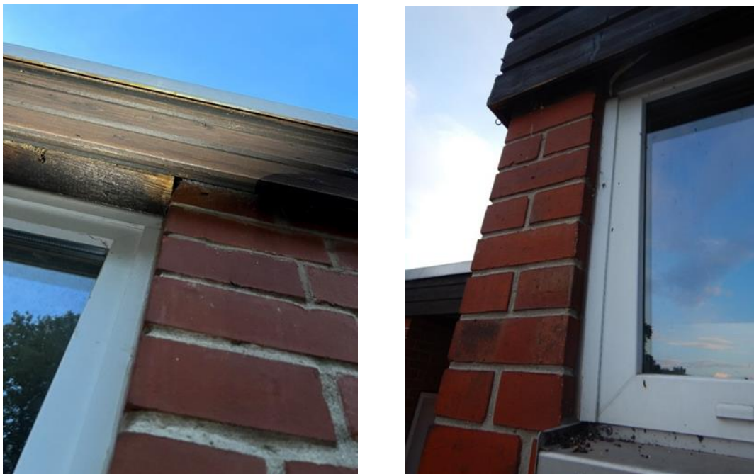
Abbildung 7: Beispiele für weitere, potenziell von Fledermäusen als Quartier genutzte Bereiche des Gebäudes: verfärbtes Holz, Kotspuren auf Fensterbänken und an der Fassade (eigene Aufnahme August 2022, PGL TNL GMBH 2022)
