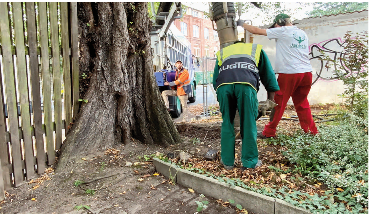
Abbildung 12: BV E-Damm Neubau; Engelbostler Damm, 30167 Hannover; Wurzelerkundungen beim sachgegenständlichen Ulmen-Altbaumes (Grenzbaum) auf dem Nachbargrundstück (Gundlach) mit Wurzelfreilegung in dem extensiv genutztem Hinterhofbereich zum Zeitpunkt der Inaugenscheinnahme am 23.09.2021 durch Großsaugtechnik; Blickrichtung West.
