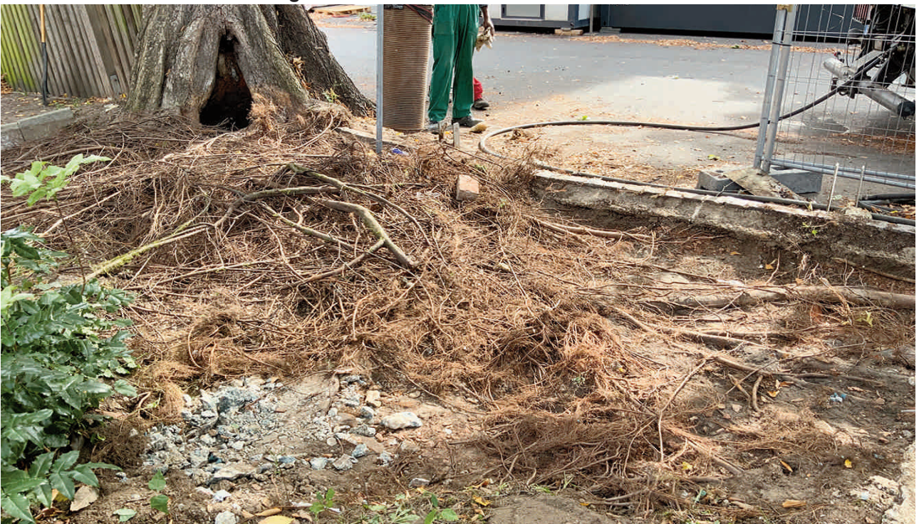
Abbildung 14: BV E-Damm Neubau; Engelbostler Damm, 30167 Hannover; Wurzelerkundungen beim sachgegenständlichen Ulmen-Altbaumes (Grenzbaum) auf dem Nachbargrundstück (Gundlach); freigelegte oberflächenzonal ausgebildete Wurzelarchitektur zum Zeitpunkt der Inaugenscheinnahme am 23.09.2021 in dem extensiv genutztem Hinterhofbereich.
