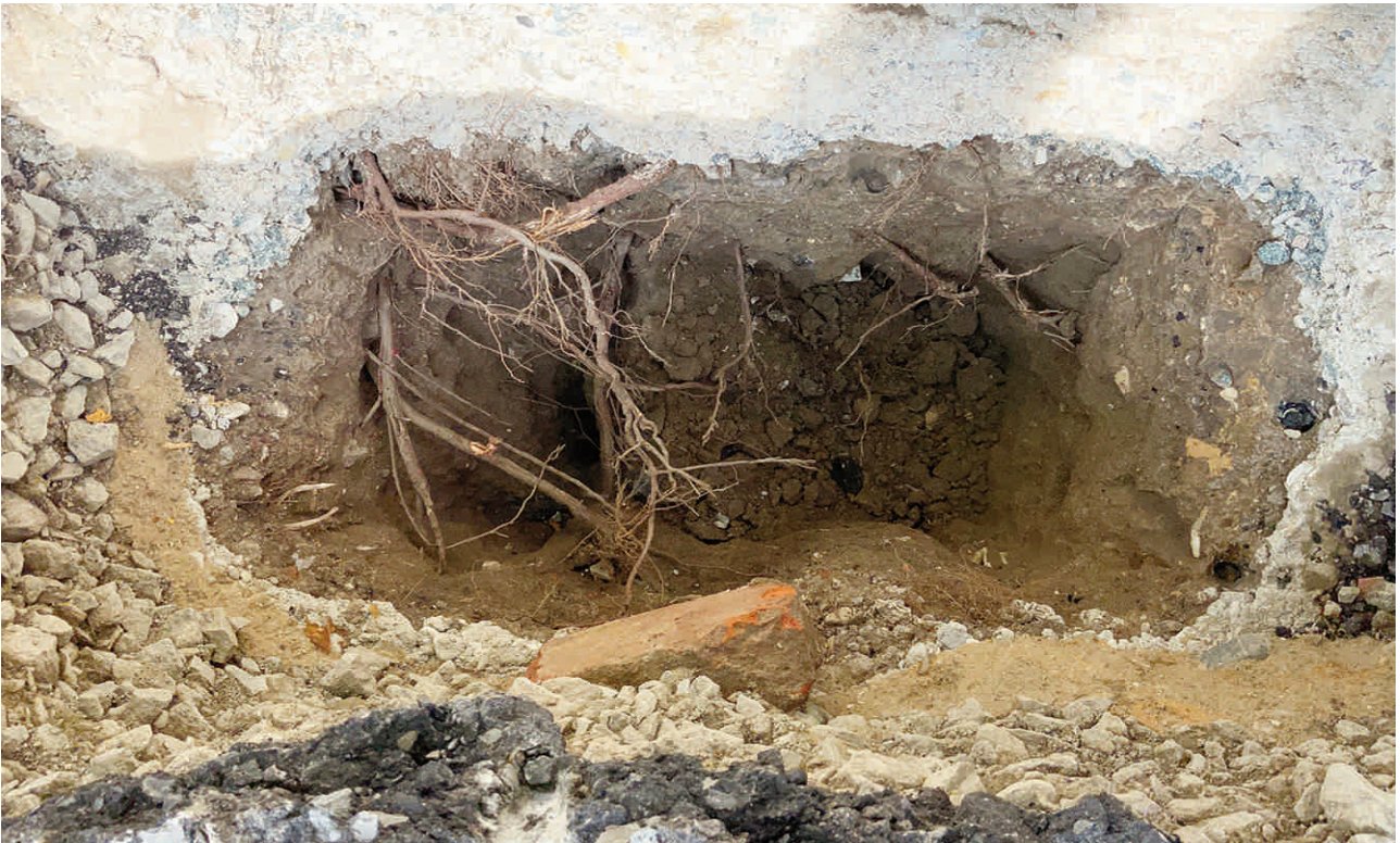
Abbildung 11: BV E-Damm Neubau; Engelbostler Damm, 30167 Hannover; Stammfuß nahe Schurfe in Standfußnähe in der Asphaltfläche auf dem Baugelände vormals Werksgelände Fa. Bumke mit geringem Wurzeleinwuchs im Untergrund unter dem Oberbau zum Zeitpunkt der Inaugenscheinnahme am 23.09.2021.
