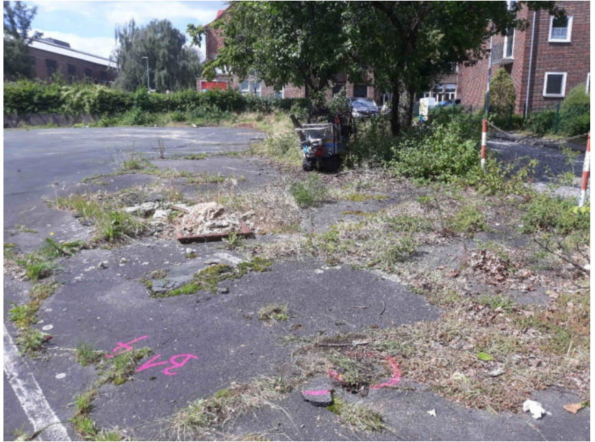
Abb. 8.: Blick auf die Bohrstandorte B 14 und B 15 - Situation am 8. August 2023
