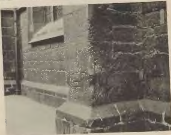
Abb. 8. Megidienkirche in Hannover. Mauerpfeiler an der Südseite mit Rissen und Ausschüssen.
