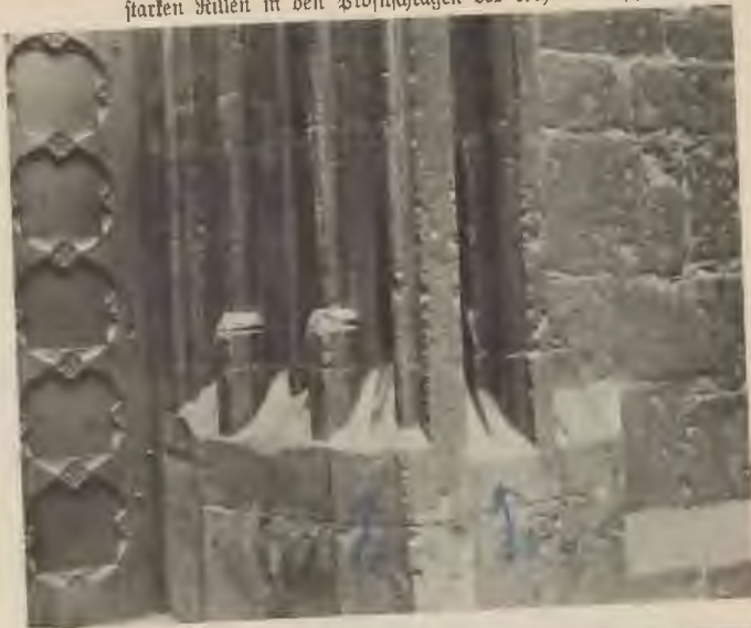
Abb. 7. Megidienkirche in Hannover. Linkes Portal an der Südseite mit starken Rissen in den Profilschrägen des rechten Torpfeilers.
