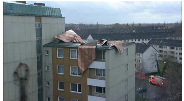
Zerstörte Kupferverkleidung des Daches (Foto: Hannover Reporter)
