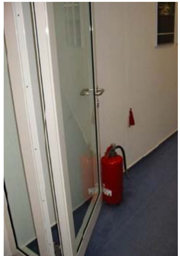
Mit einem Handfeuerlöscher offengehaltene Rauchschutztür (Foto: Feuerwehr Hannover)
