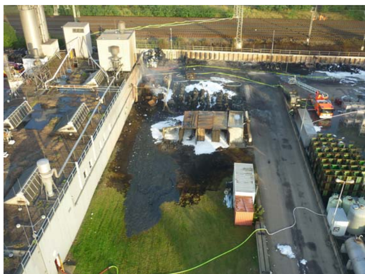
Im Vordergrund sind die ausgebrannten Baucontainer zu sehen – vermutlich die Brandausbruchsstelle. (Foto: Feuerwehr Hannover)
