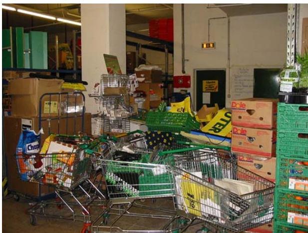
Zugestellter Notausgang in einem Lagerraum (Foto: Feuerwehr Hannover)
