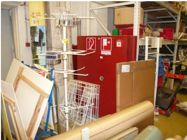
Zugestellter Wandhydrantenschrank in einem Lagerraum (Foto: Feuerwehr Hannover)
