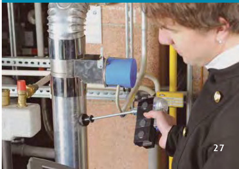
Abgasmessung an einer Gasheizung
