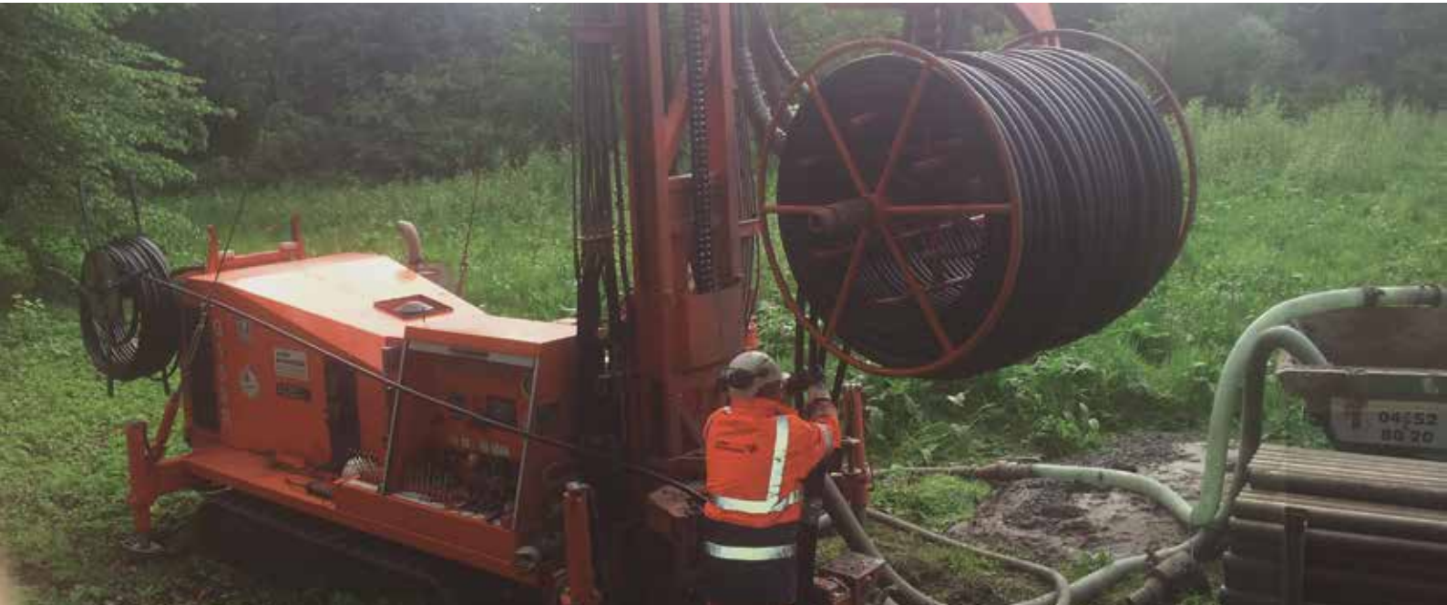
Bis 100 m reichen Erdwärmesonden in den Untergrund
